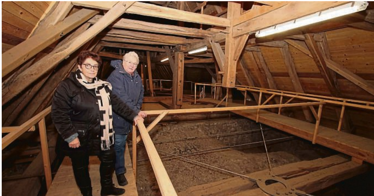
Haben maßgeblich an der Sanierung mitgewirkt: Dekanin Carmen Jelinek (links) und Bauausschussmitglied Silke Does auf dem Dachboden der Stiftskirche. Manche der hier verbaute Balken sind knapp 1000 Jahre alt. FOTOS: MORITZ GORNY
