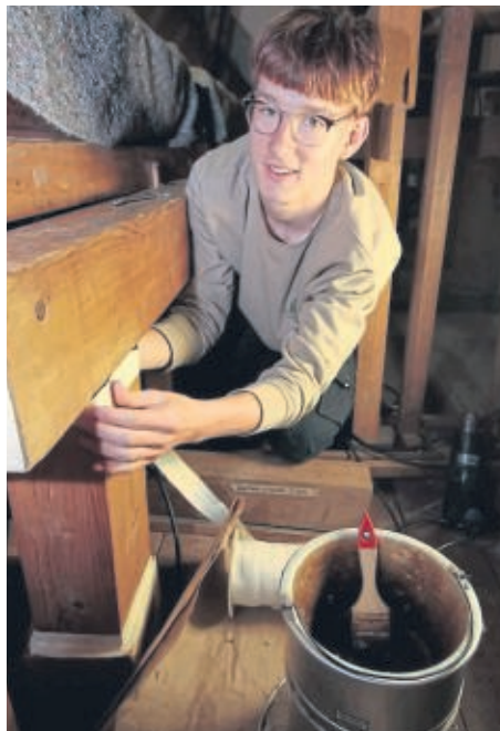
Empfindet seine Arbeit als Privileg: Der Azubi Hannes Hering verdichtet die Kanalanlage, damit der Orgel nicht die Luft ausgeht.
