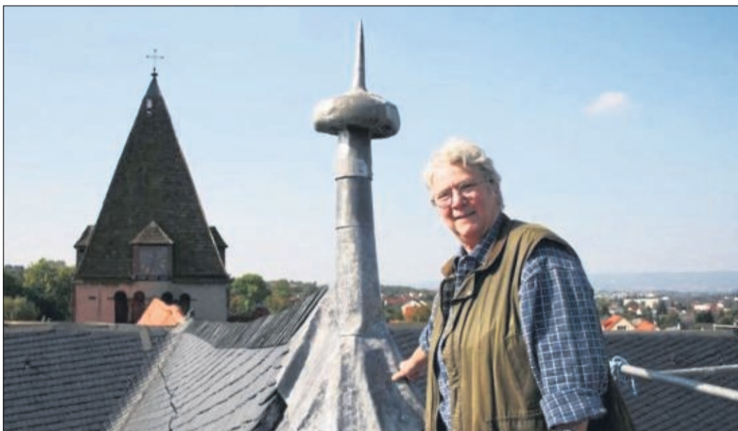
Kurz nachdem die neue Turmzwiebel aufgesetzt wurde: Silke Does steht in luftiger Höhe, ein erhabener Moment für die 68 Jahre alte Frau: „Der Blick auf Kaufungen war großartig.“
