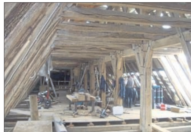
Viele Jahre auf dem Buckel: Das über 600 Jahre alte Dachgebälk der Stiftskirche wurde Stück für Stück erneuert. Teils wurden komplette Eichenbalken ausgetauscht, teils auch nur stückweise ergänzt.
